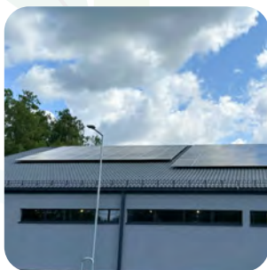
Panele słoneczne na dachach budynków publicznych
