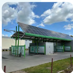
Panele słoneczne na dachach budynków publicznych
