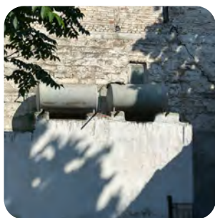
zbiorniki ogrzewające wodę
